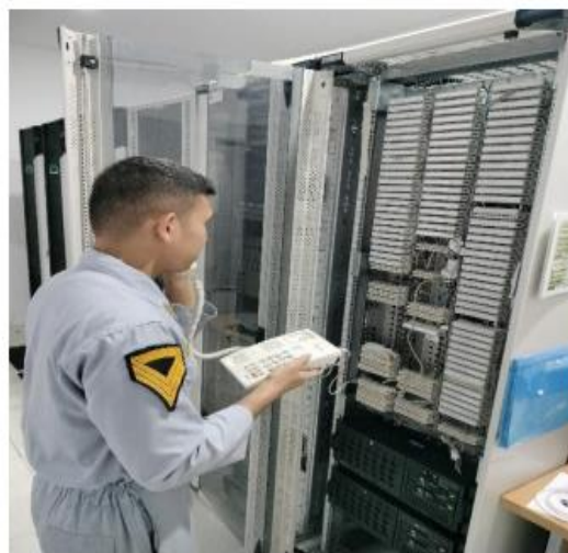
Gambar 15. Pengecekan Kembali VSAT Via Terminal MDF
