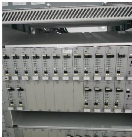
Gambar 11. Pengecekan Lampu Indikator pada ALC VCCS
