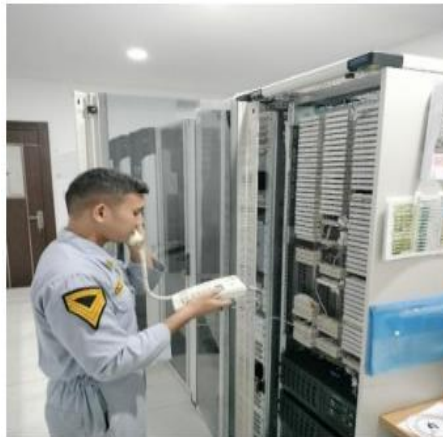
Gambar 12. Pengecekan VSAT Via terminal MDF
