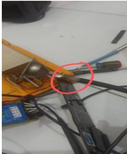
Gambar 3. Kabel konektor yang rusak Sumber: Kantor LPPNPI Cabang Palembang
